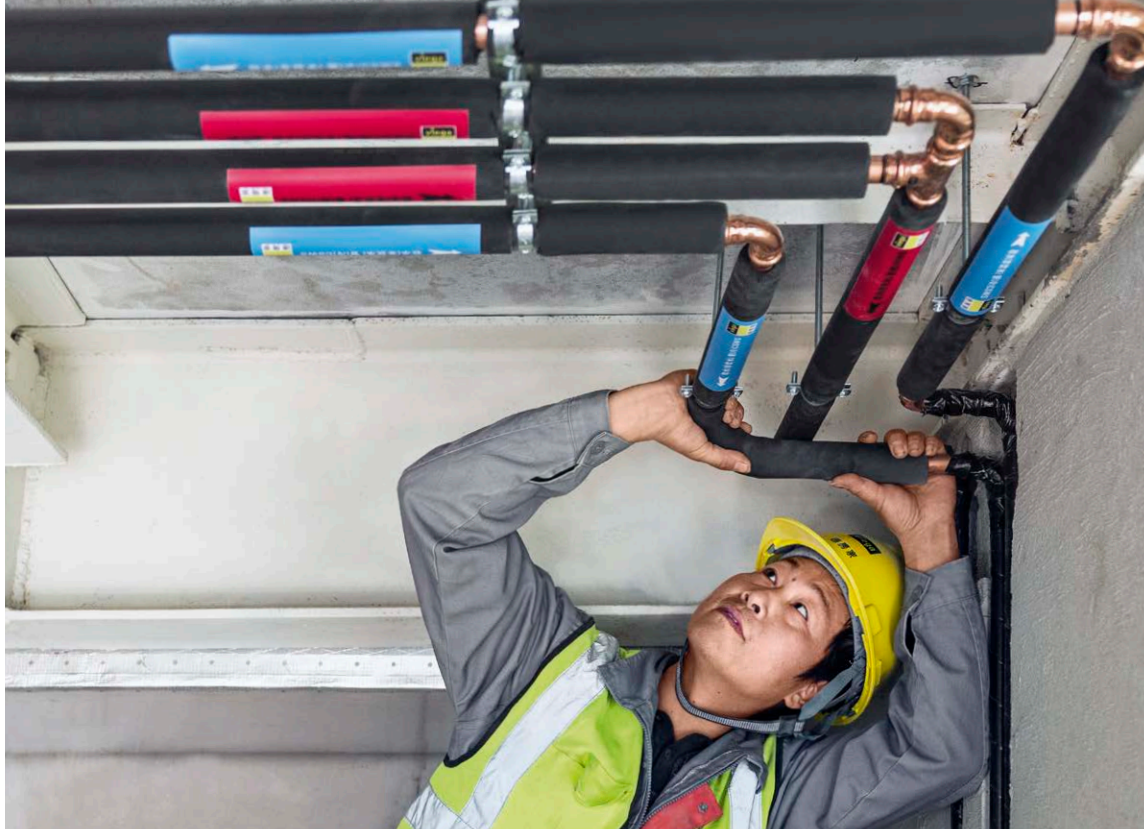
Negli edifici sono stati installati oltre 100.000 m di tubazioni di rame Viega Profipress.
