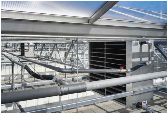
L'estrema resistenza dei tubi di acciaio e dei raccordi Megapress consente di realizzare l'installazione con un minimo numero di punti di fissaggio celati dai soffitti dello stabilimento di Bottrop.
